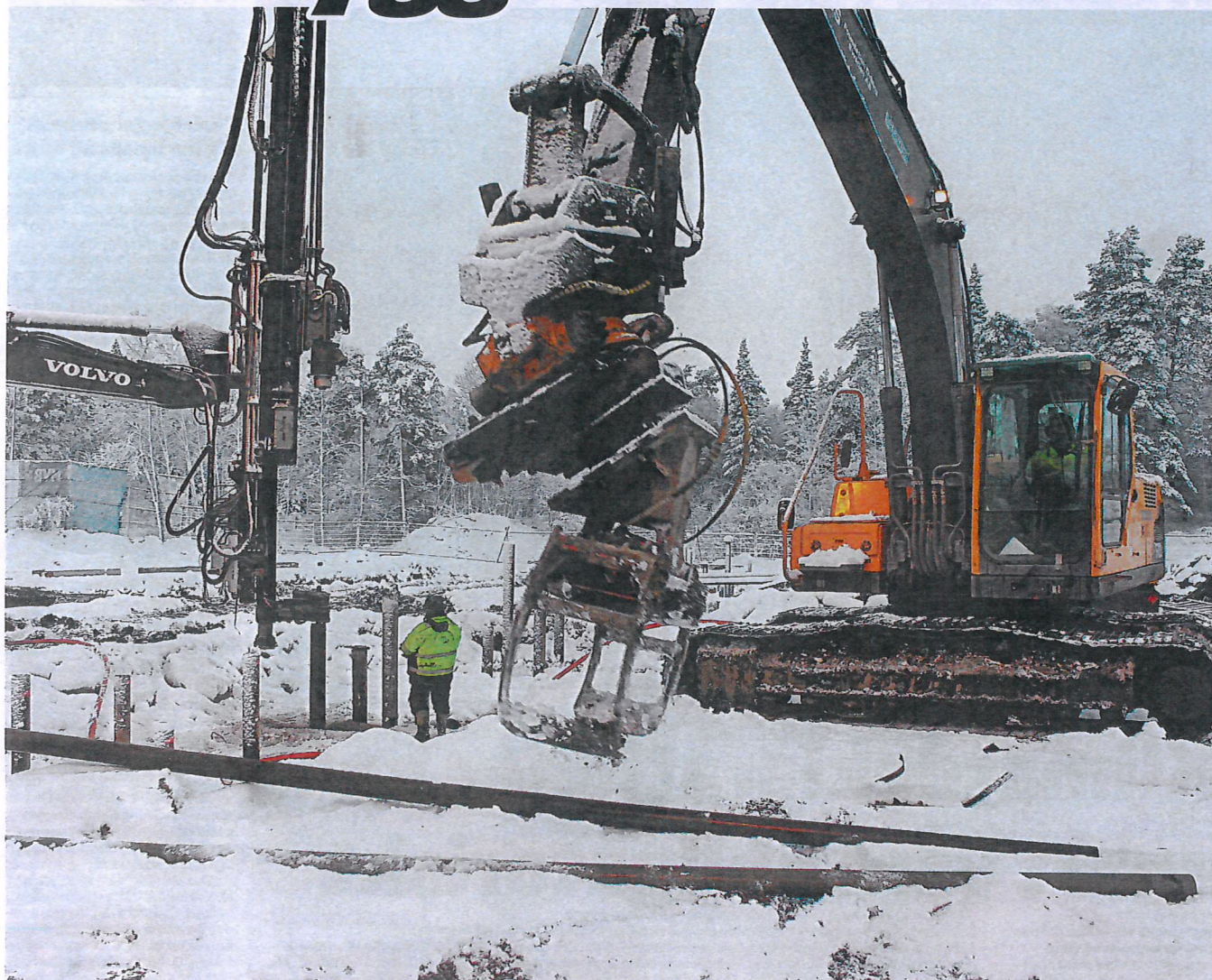
Grundläggningen i Gubbängen har varit avancerad. Cirka 300 stältpålar måste ner i backen innan stommen kan resas till våren.
