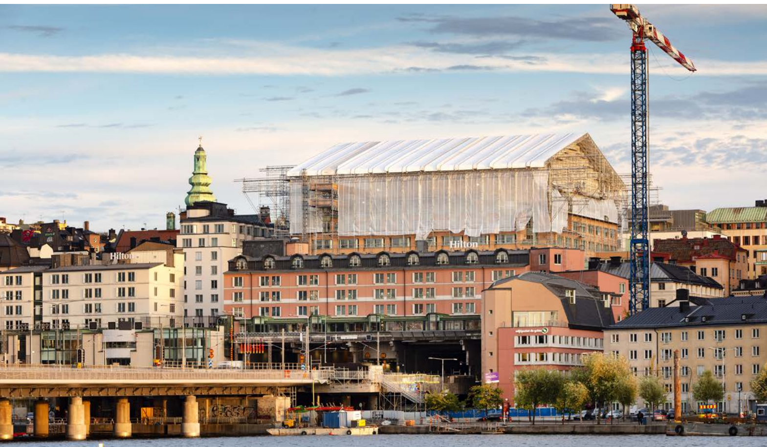
Överkirkaren, Stockholm. Renovering och påbyggnad av fastighet med restaurang och takbar. Beställare: Slussgården.
